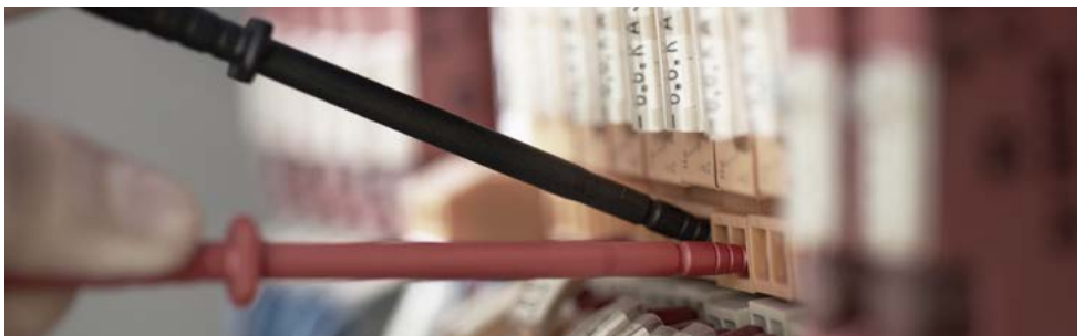
保险丝盒和配电箱的测量
